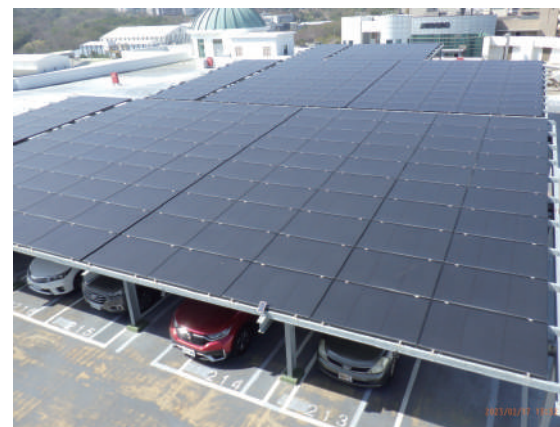
太陽能發電設施29.25KW
