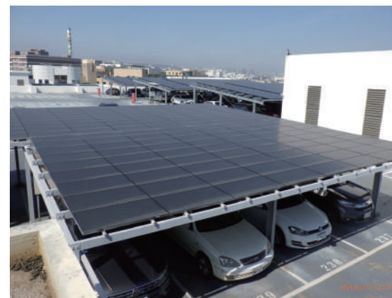
太陽能發電設施108.5KW
